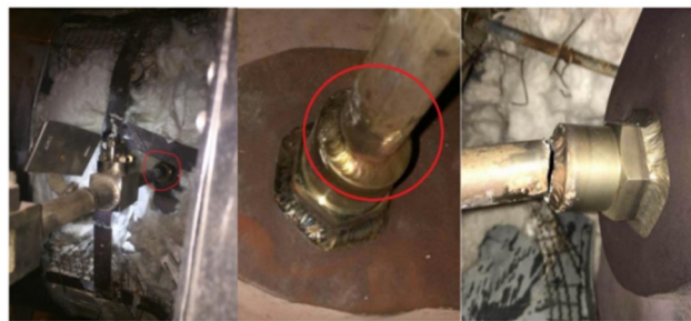
图1 小支管焊接接头疲劳断裂
